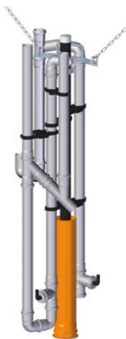
Klarwasserheber und Überschussschlammheber
