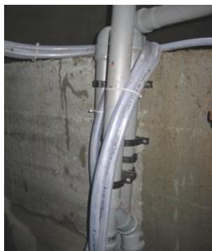
Schläuche an den Hebern nach oben geführt
