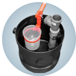
Probenahmetopf in der Kläranlage
